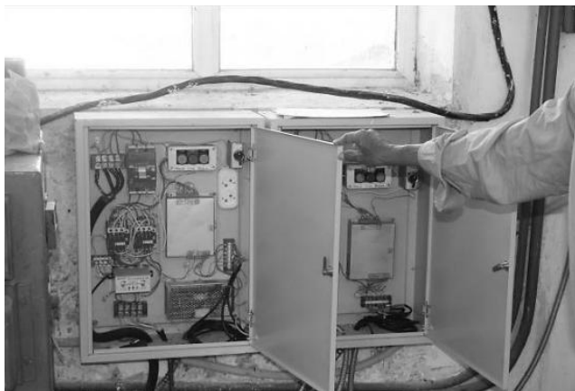
Рисунок 4 – Щит управления затворами
