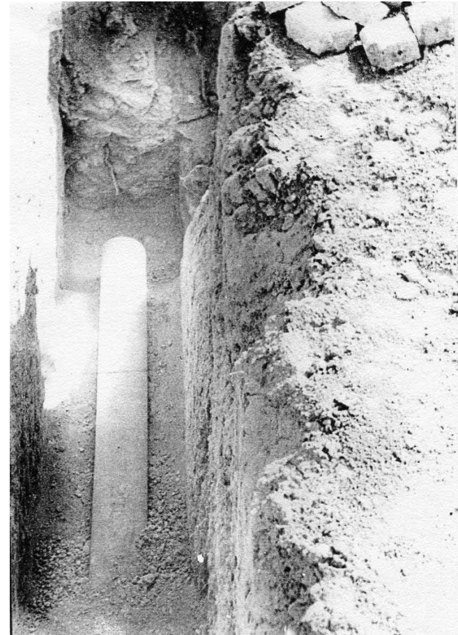
Рис. 4.29 б. Устьевая труба опытной дрены
