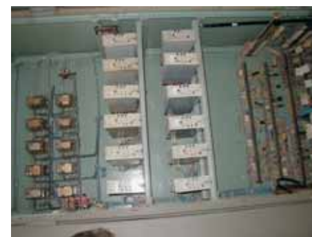
Рис. 3. Шкаф с преобразователями
