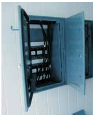
Рис. 4. Шкаф контроллеров с модулями ввода и вывода
