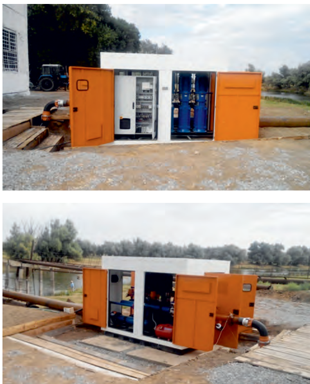
Рис.12.9. Насосная установка «Ладога» на оросительной сети (г. Камызяк, Астраханская область)
