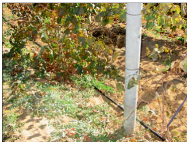
Рис. 8.16. Поливной трубопровод в ряду сада и виноградника
