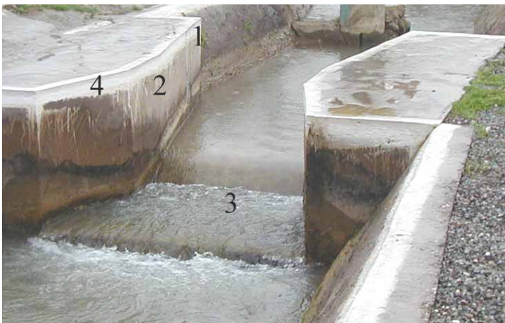
Рис. 2. Головной гидропост (лоток Паршала) на канале второго порядка АВП «Акбарабад» 1 - вертикальные стенки, 2 - горловина, 3 - дно, 4 - отводящий раструб (диффузор)
