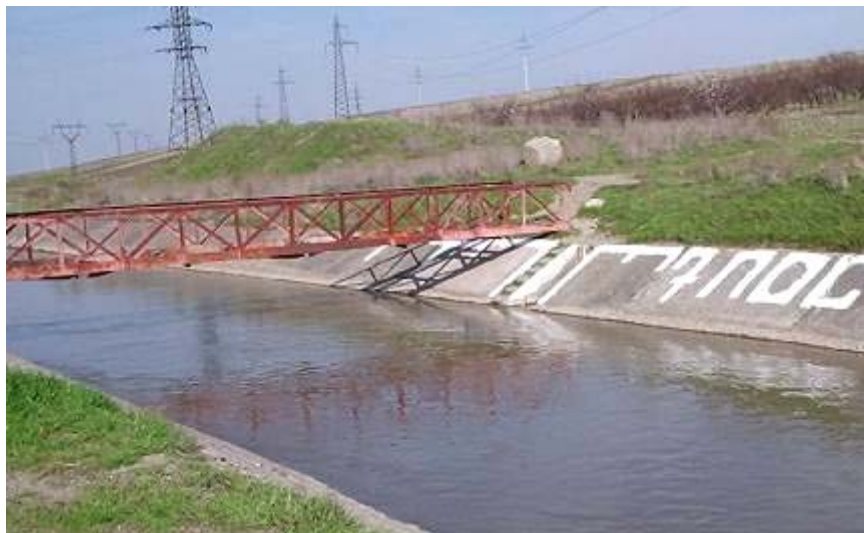
Рис.1. Гидрометрический пост типа «ФР» оборудованный гидрометрическим мостиком
