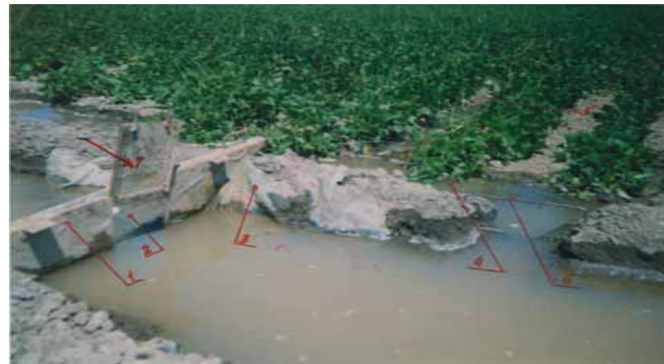
Фото 6. Жесткий, с регулирующим окном, перегораживающий подпорный щит
