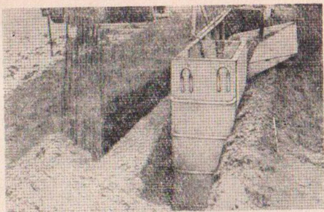
Рис. 3. Характер обрушения стенок при работе Д-659А с засыпающим транспортером.
