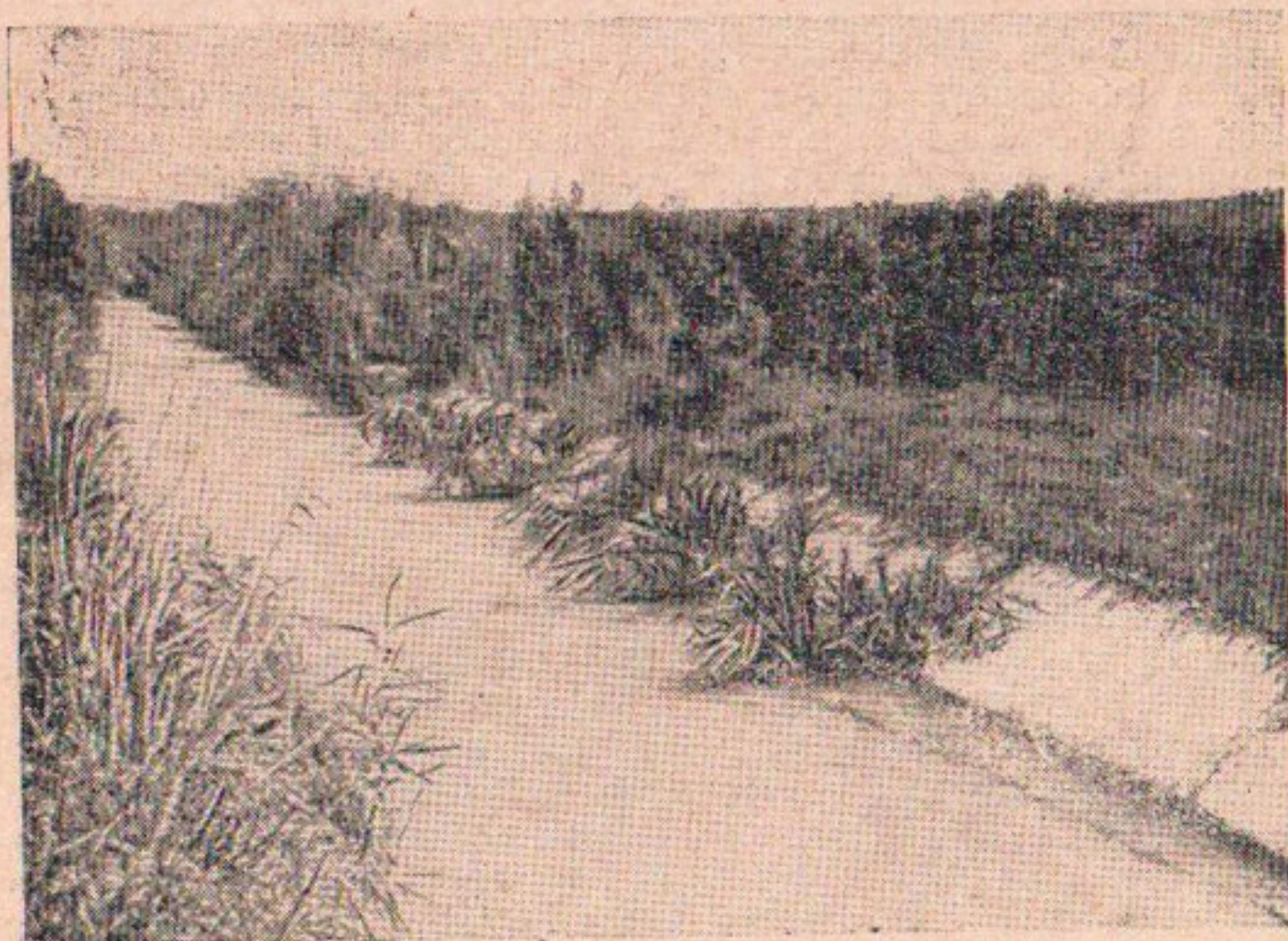
Рис. 61. Прорастание растительности на канале, облицованном плитами.
