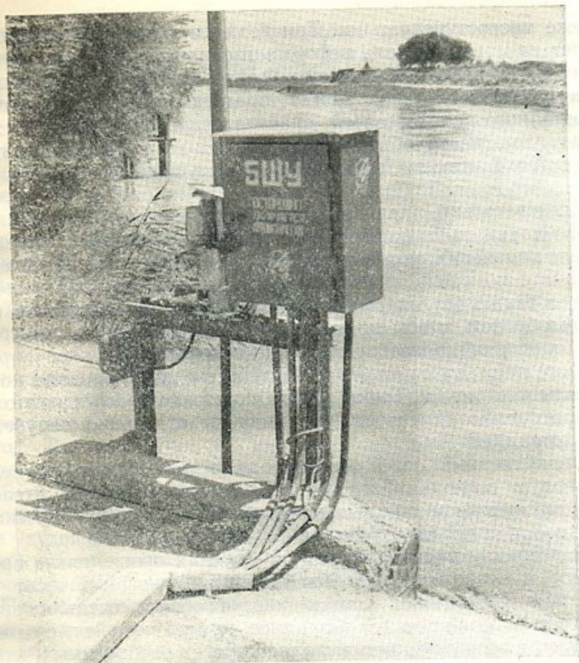
Рис. 6. Автоматизированный пульт управления на южном Голодностепском канале.
